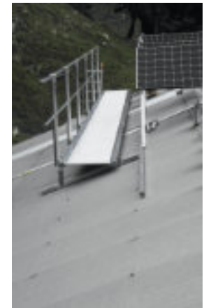
Eine Sicherheitseinrichtung über den Dachgiebel sowie ein Podest erleichtern die Arbeiten auf dem Dach und sichern die Arbeiten an der Solaranlage, Dach und Dachrinne.
