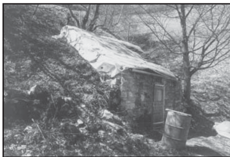
Das hier noch baufällige Dach wurde Ende Mai saniert.
