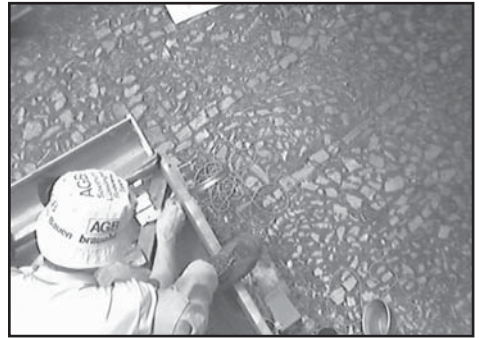
Auch ums Eck laufen die Dachrinnen
