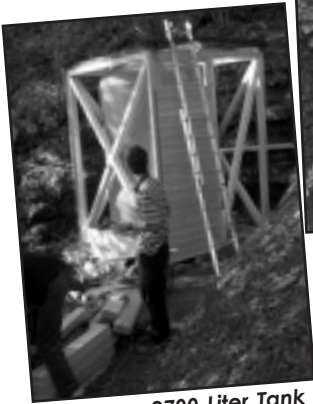
Der neue 9700 Liter Tank
